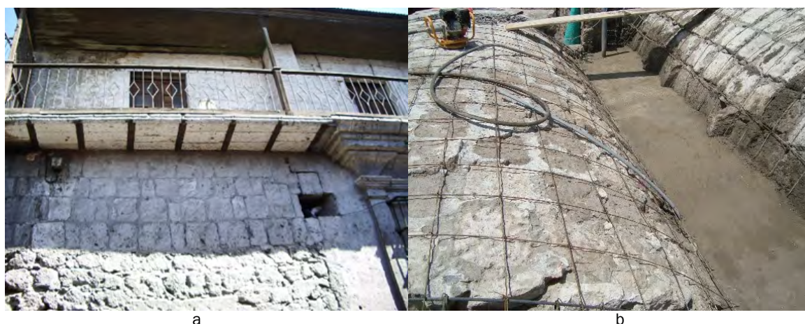
Figura 9. Estructuras mixtas. a. Balcón corrido con rieles ferroviarios sobre casa colonial arequipeña. b. Armado con malla de acero antes del hormigonado de bóvedas. Fuente: autora.
